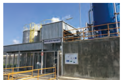
排水リサイクル設備(タイ工場)
